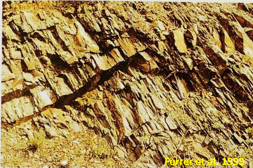
Pizarras ordovícicas. Calidad media. Grado de fracturación alto. Grado de meorización: III.
